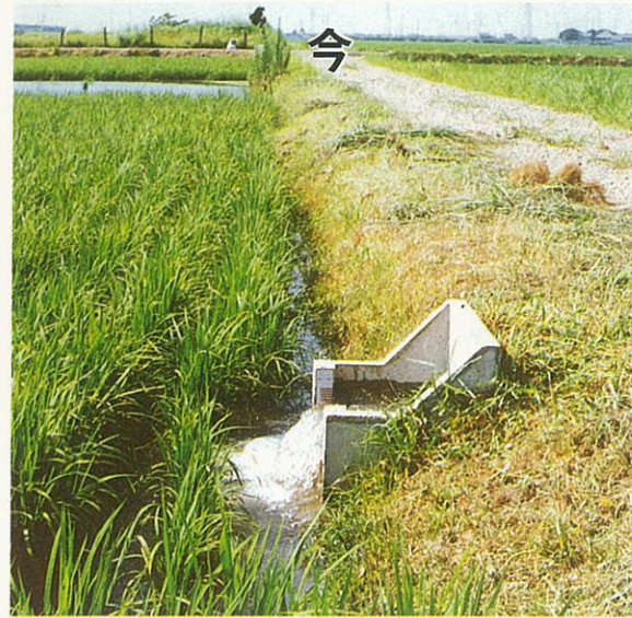
▲圃場に設けられた給水栓
