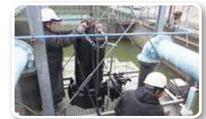
日置2揚水機場
