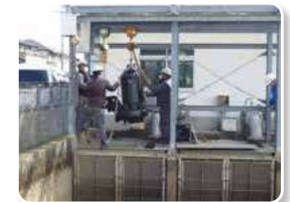
土地改良施設維持管理適正化事業 (唐臼揚水機場)
