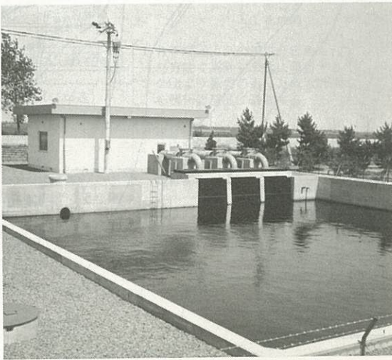
鍋田(稲山)揚水機場
